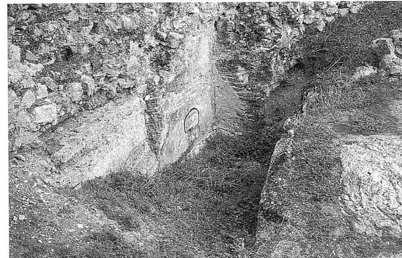
28. Vista general del aljibe, muy colmatado por derrubios procedentes del patio de armas
